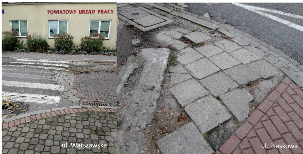
Fot. 6. Przykłady zniszczonej nawierzchni ciągów pieszych na obszarze rewitalizacji
