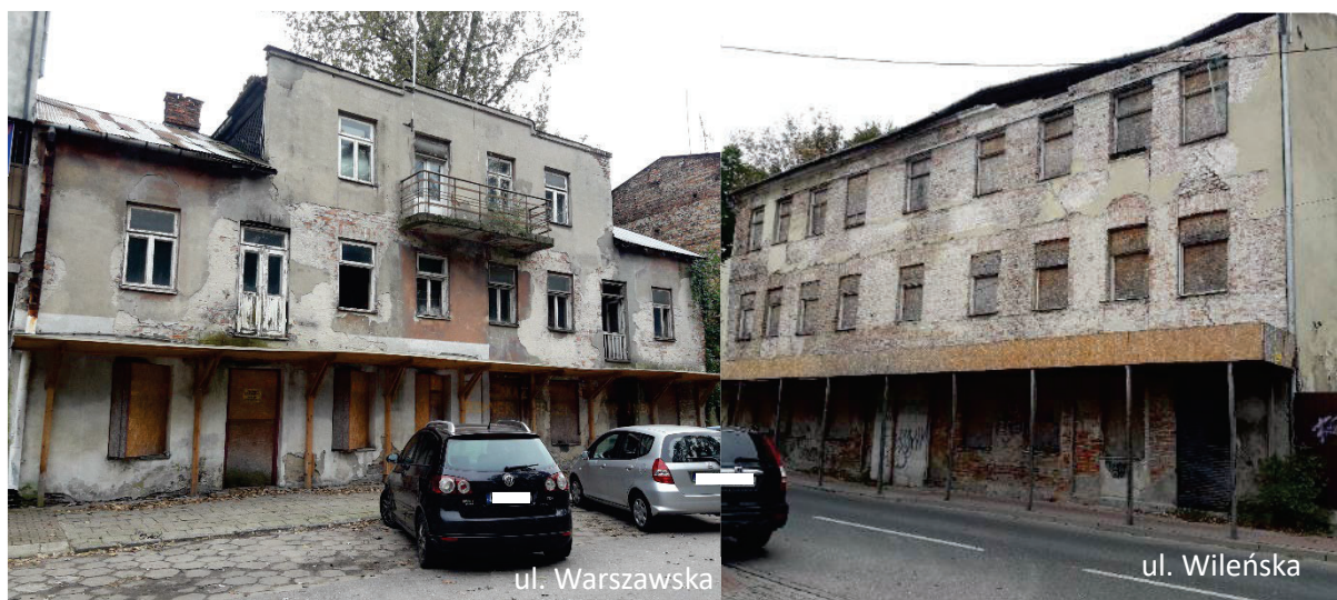
Fot. 11. Przykłady kamienic wyłączonych z użytkowania na obszarze rewitalizacji
