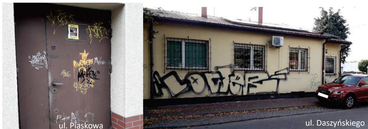
Fot. 1. Przykłady wandalizmu na obszarze rewitalizacji
